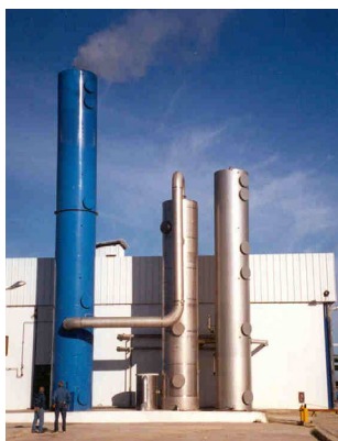
Prozesstürme im Aussenbereich
