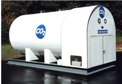
Horizontaler CO 2 -Lagertank
